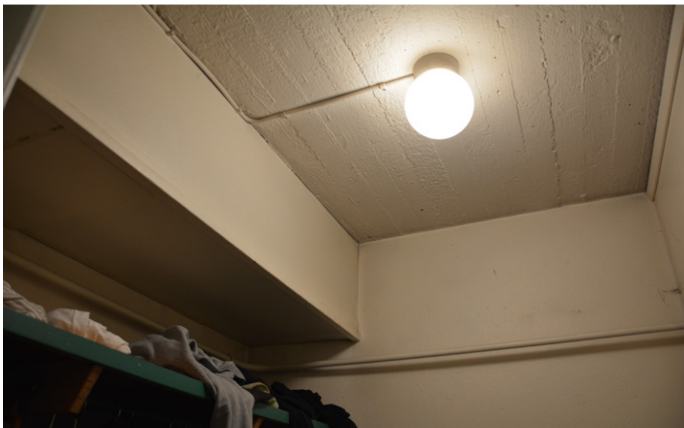
Takarmatur med kupa i vitfrostat glas, placerad i omklädningsrummet. Vlm_kmvSB-3314.
