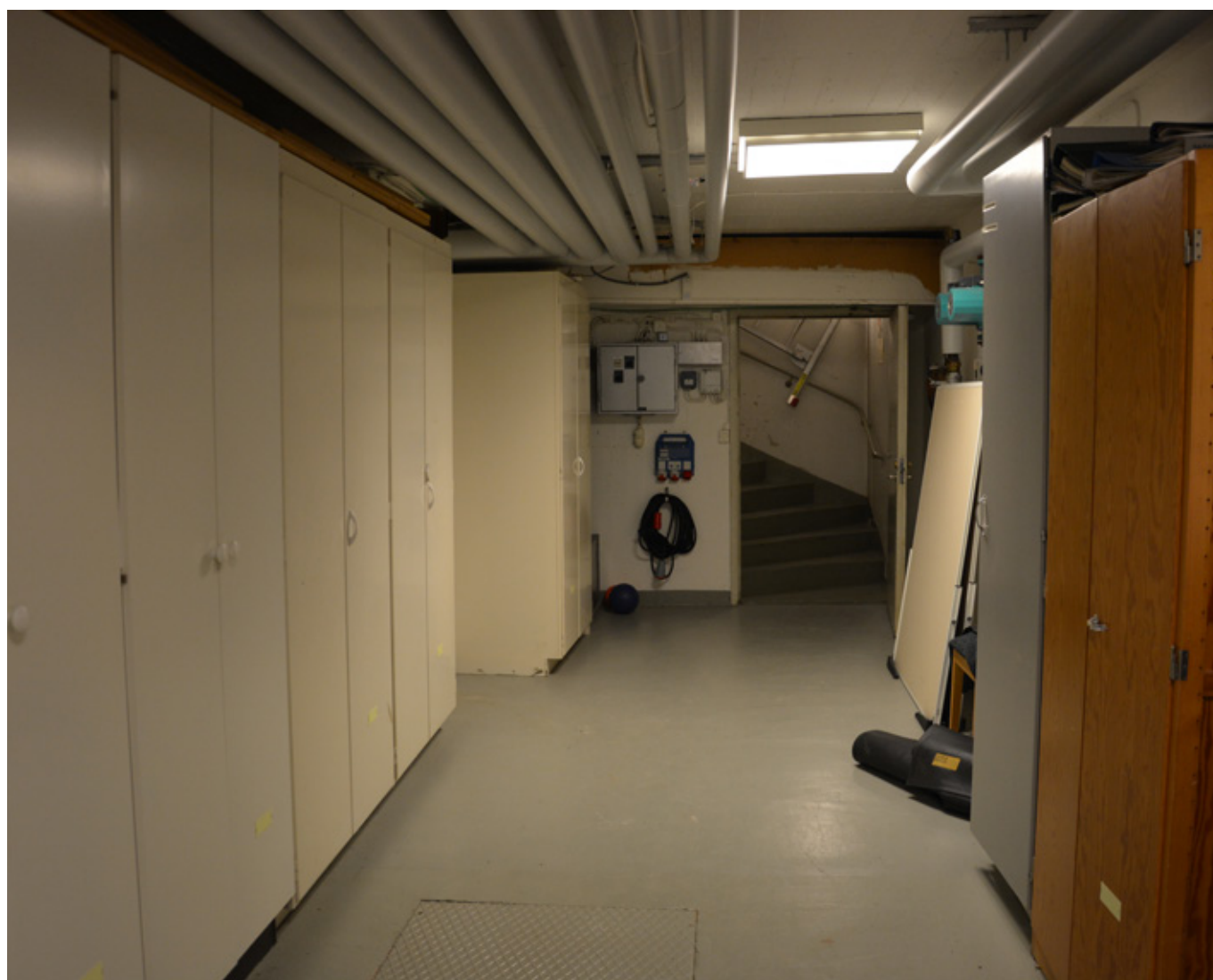
Källarutrymme med gråmålat betonggolvt, lysrörsarmatur i kvadratisk plastskydd samt trapp upp mot huvudvåning. Vlm-modkaEK-3875.
