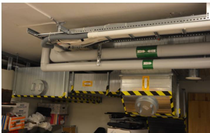
Ventilation och rörledning. Vlm_modkaEK-992.
