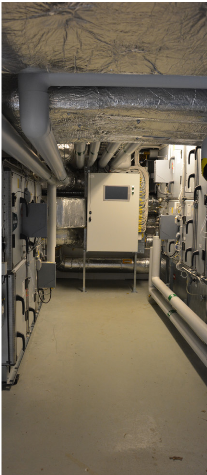
Ventilationsaggregat i fläktrummet. Vlm_modkaEK-1168.
